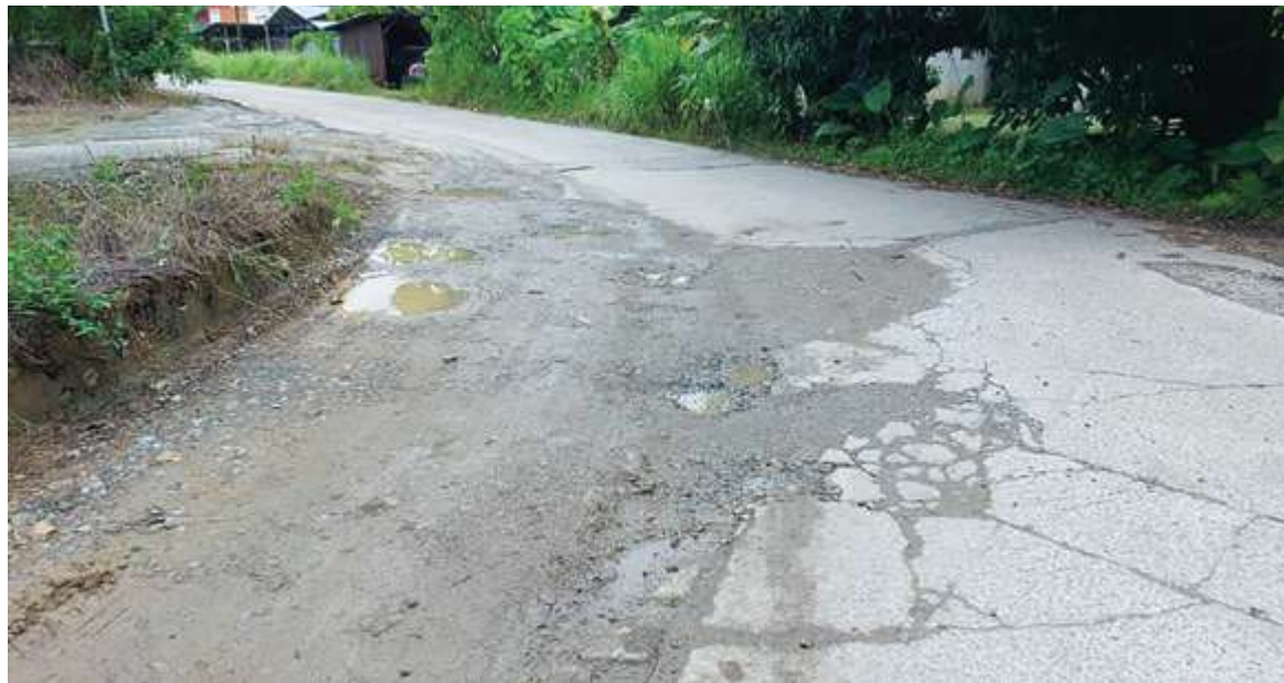
JALAN kampung yang rosak terutama ketika musim hujan menyukarkan penduduk untuk keluar dan masuk.
