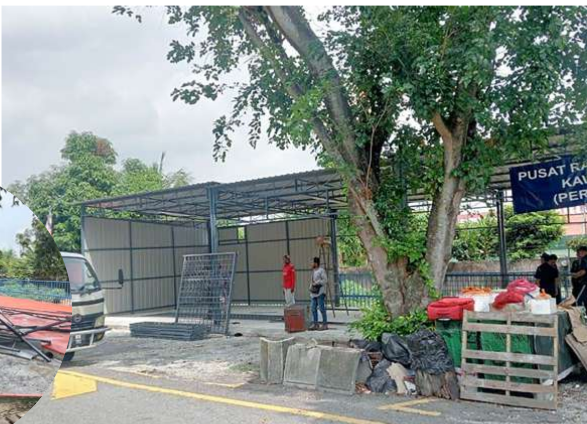
STRUKTUR yang baru siap dibina tanpa kebenaran dirobuhkan selepas mendapat bantahan daripada komuniti setempat.
