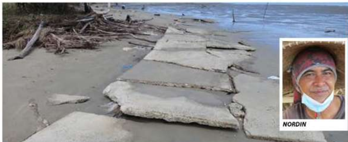
KEADAAN tembok konkrit binaan penduduk kampung yang musnah kerana hakisan pantai yang serius.
